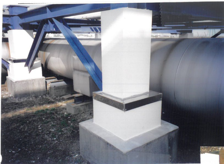
鋼脚部の耐火ボード被覆 コンクリート上面部の金属保護カバー
